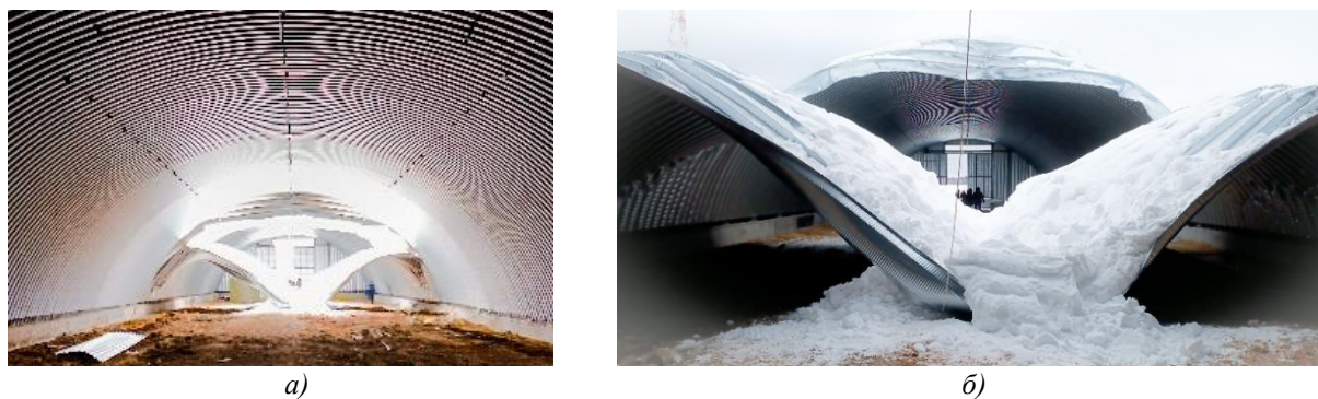
Рисунок 5. Обрушение бескаркасного здания: a – общий вид; b – вид на зону обрушения Fig. 5. Collapse of a frameless buildings: a – general view; b – view of the collapse area
