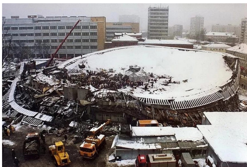
Рис. 1. Обрушение покрытия Басманного рынка (Москва, 2006)
