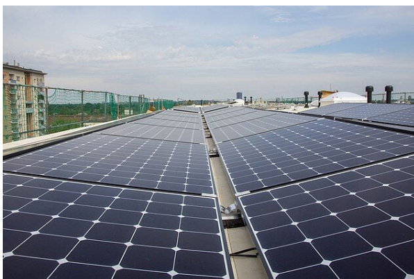
Рис. 6. Солнечные батареи на торцах Fig. 6. Solar panels at the ends
