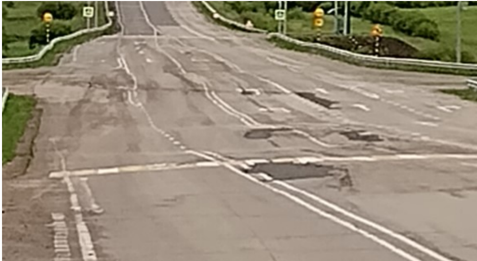
Рис. 10. Просадки дорожного полотна на участке 288 км автомобильной дороги «Амур». Фото Д. О. Сергеева
