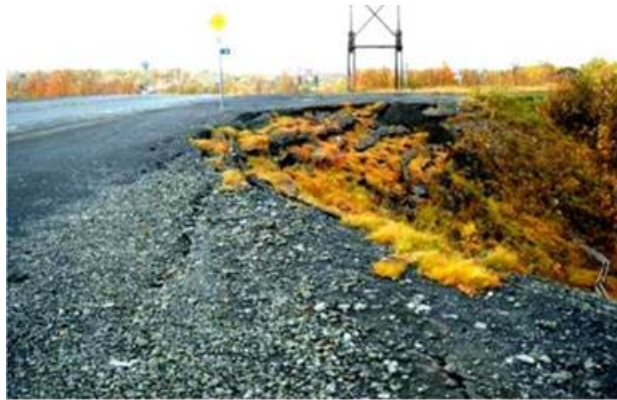
Рис. 5. Ступенчатое отседание основной площадки насыпи автомобильной дороги «Норильск – Талнах» [8]
