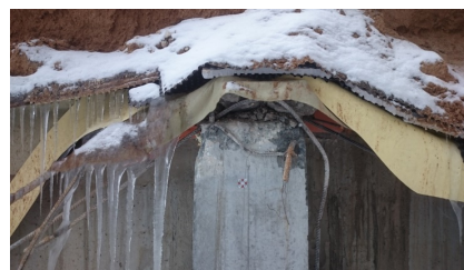
Рис. 4. Обрушение покрытия подземной парковки в г. Сергиев Посад, ул. Фестивальная. Опорный узел моноконтингента и сборная железобетонная колонна
