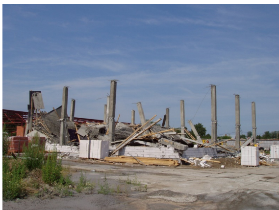
Рис. 1. Обрушение строящегося здания МРЭО ГИБДД в г. Коломна, ул. Митяево И с т о ч н и к: выполнено М.В. Мозговым, Г.Э. Окольниковой
