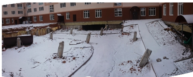
Рис. 3. Обрушение покрытия подземной парковки в г. Сергиев Посад, ул. Фестивальная
