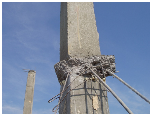
Рис. 2. Обрушение строящегося здания МРЭО ГИБДД в г. Коломна, ул. Митяево. Опорный узел перекрытия первого этажа И с т о ч н и к: выполнено М.В. Мозговым, Г.Э. Окольниковой
