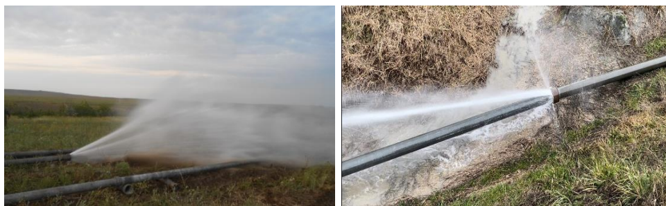
Рис. 3. Примеры повреждений СРТ
