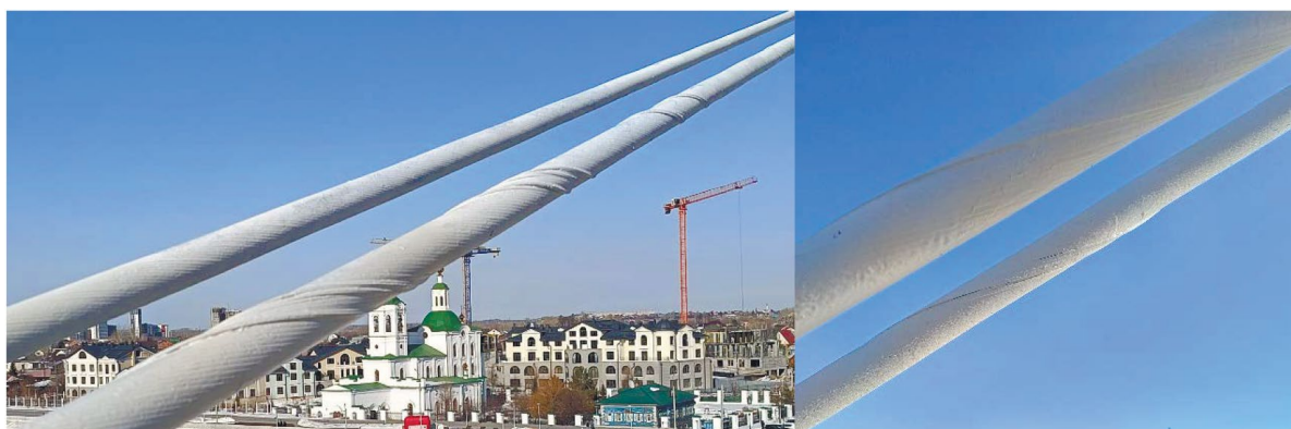
Рис. 2. Дефекты наружного слоя канатов.
