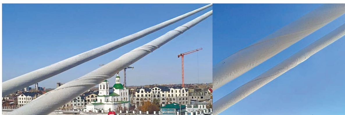
Рис. 2. Дефекты наружного слоя канатов.
