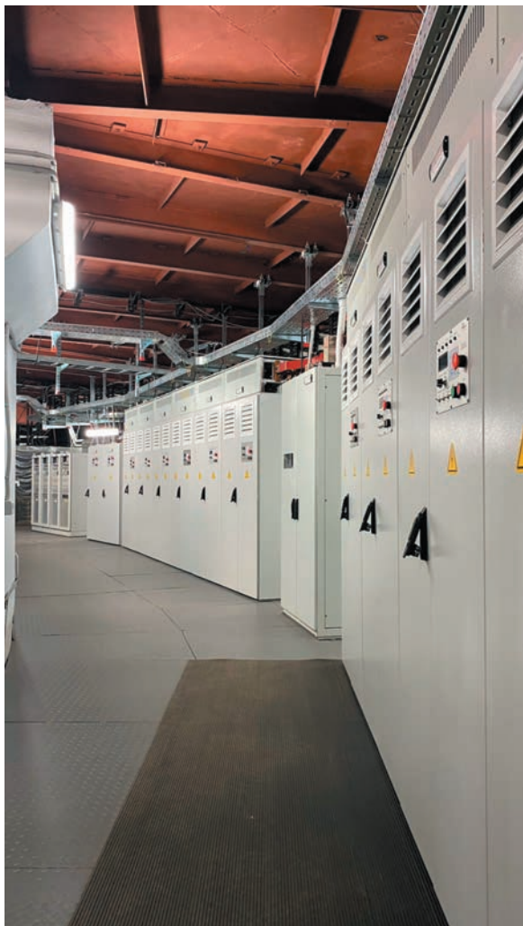
Рис. 6. Внешний вид ПИТ11-260, установленного на цокольном этаже Бустера.
